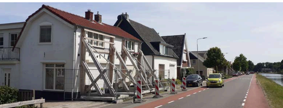
Bij diverse huizen langs het kanaal is zakkingsschade ontstaan.
