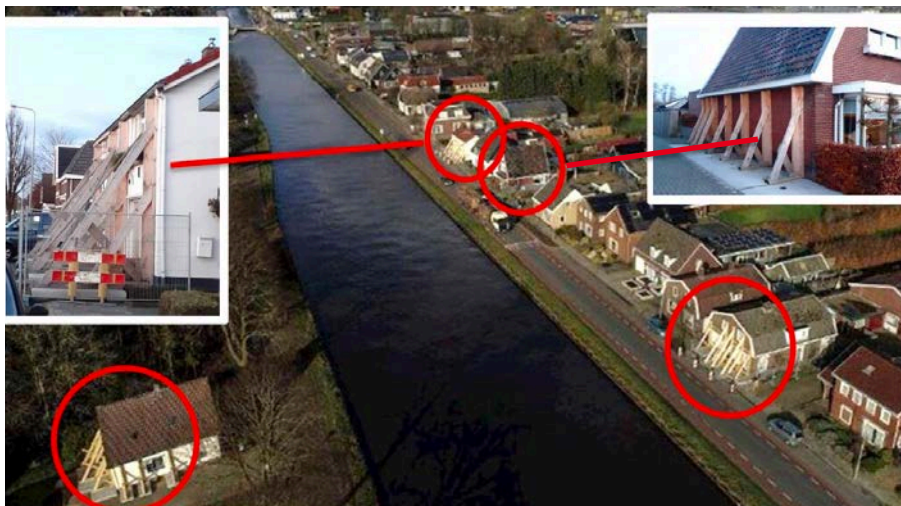
De luchtfoto van RTV Oost toont de verzakte en gestutte huizen langs het kanaal aan de Vriezenveenseweg en de Vierzonenweg in Vroomshoop.
